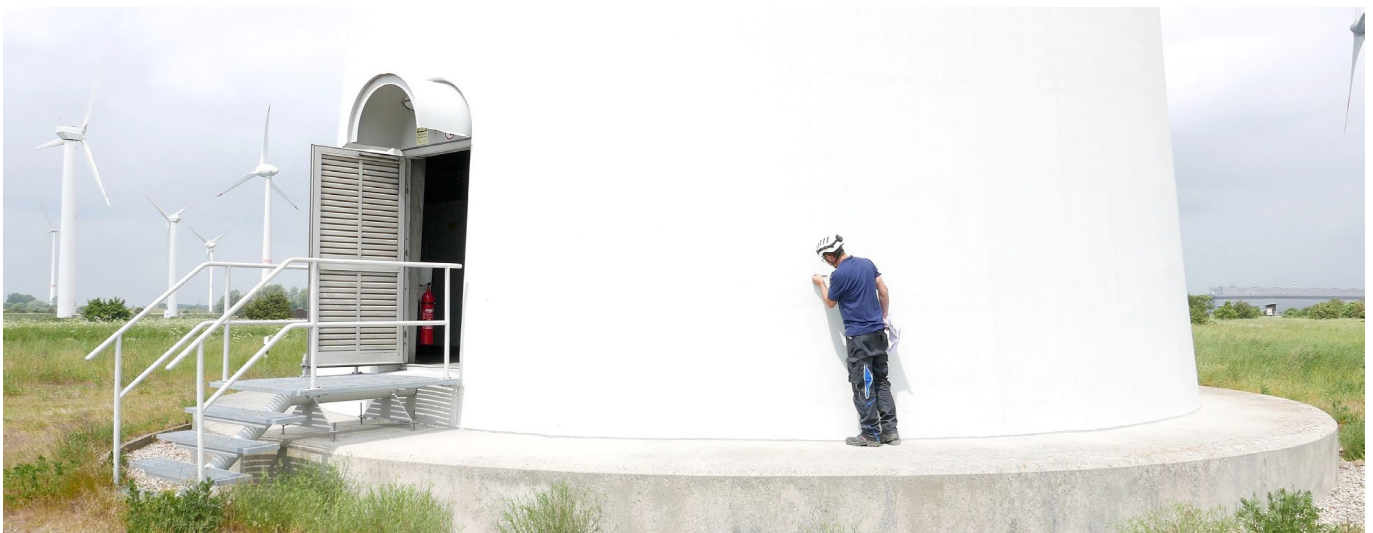
Abbildung 1: Die Windkraftanlage wird von außen inspiziert und festgestellte Risse vermessen.
