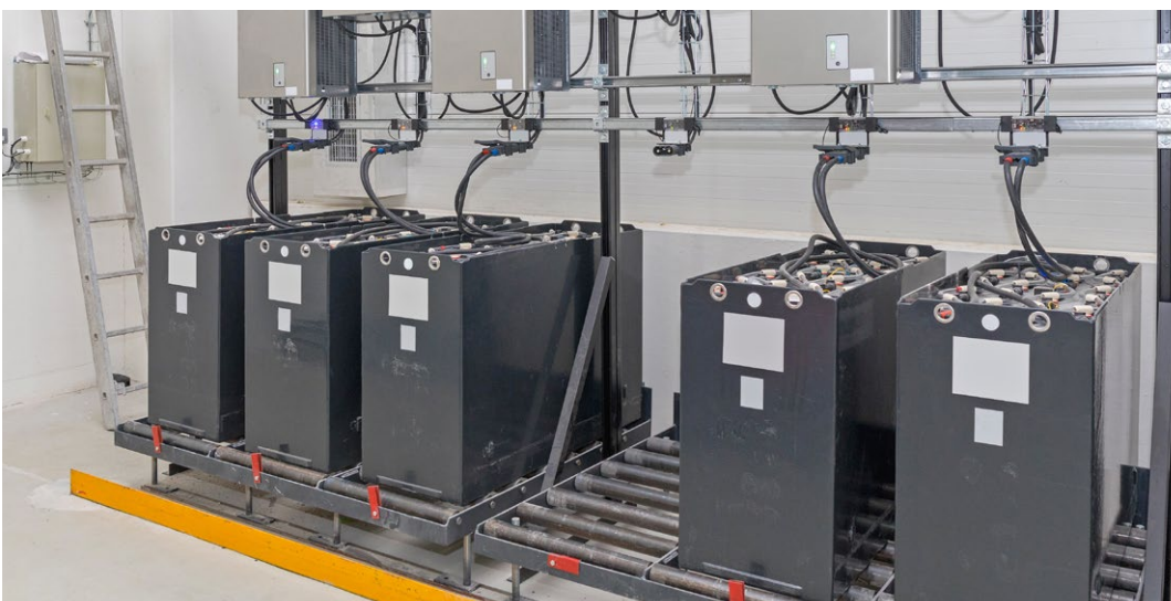
Batteriespeicher helfen, Lastspitzen zu senken und Energie kosteneffizient zu reduzieren.
